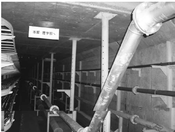
図5．地下共同溝のヘリウムガス回収配管
