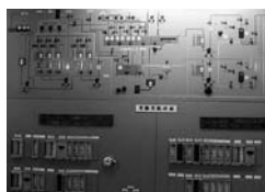
実験排水処理設備
