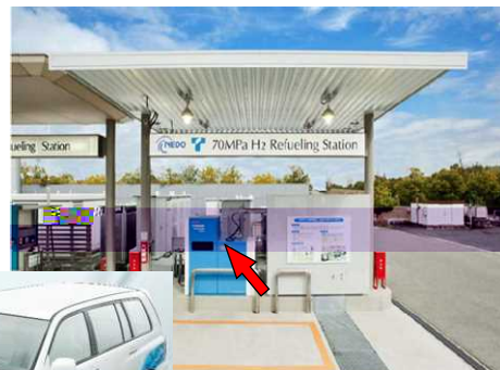
水素ステーション
