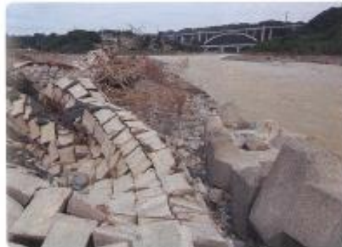
大雨でふえた水によってこわされたてい防 [神奈川県 相模原市 相模川 2007年]
